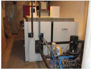
Figur 24: Anlægget set fra bagsiden. Trykrør til den kondensatoren ses på billedet sammen med de 2 hovedpumper på anlægget. Pumperne forsyner dels fan-coils på kontorer og down flow units i serverrum med koldt vand.
