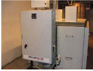
Figur 23: Maskinrumsoptstilling under færdiggørelse. Der er opsat CO 2 -alarm på siden af eltavlen. Anlægget er inddækket for dæmpning af maskinstøj. Inddækning reducerer lydtrykket for det uinddækkede anlæg fra 62 dBA til 42 dBA i 10 m.
