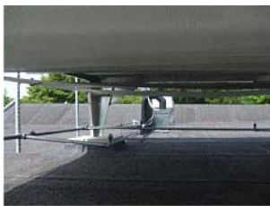
Figur 22: Nærbillede af adiabatisk befugter system. Ved udetemperaturer > 20° C aktiveres vandforsyningen og der forstøves vanddråber op imod det udspændte net. Udeluften nedkøles ved fordampning af vandet og samtidig nedbringes overfladetemperaturen på det sorte tagpap.
