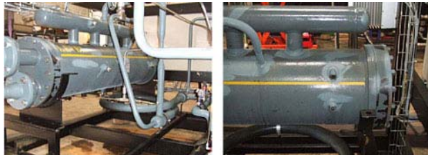
Figur 4: Layout af fordampersktion med forsøg med intern veksler samt sugegasventuri. Øverste på billedet til venstre ses HT-ventilen. På billedet til højre ses skueglas i fordampere
